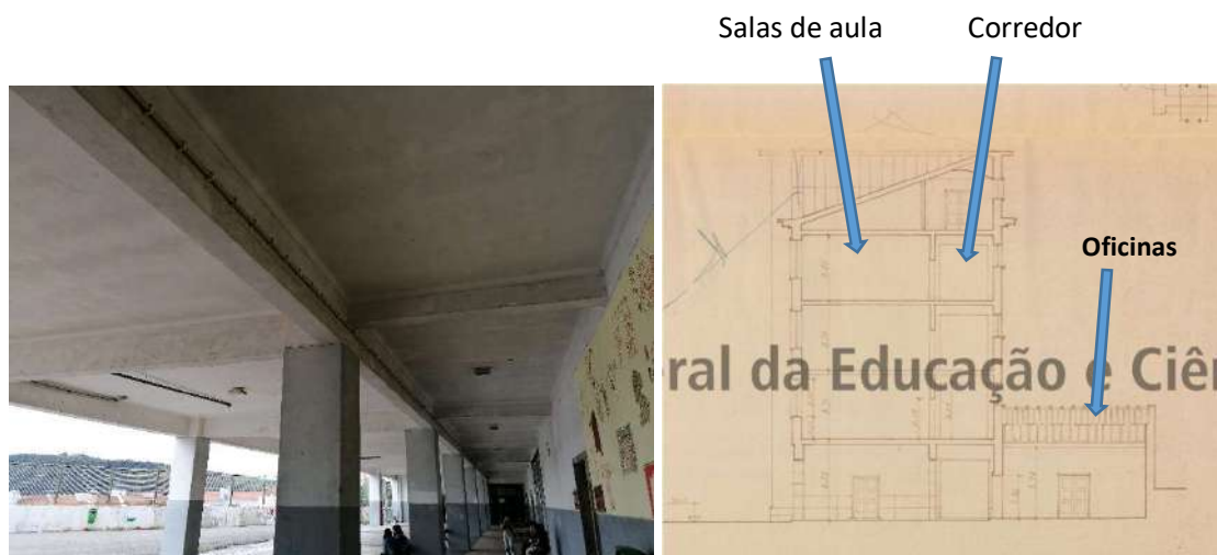
Piso térreo com zona ampla e estrutura reticulada de betão armado aparente (entrada para as oficinas à direita)
