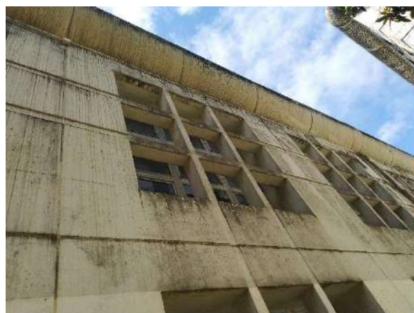
Sistema de revestimento das fachadas dos blocos da escola com recurso a painéis de betão pré-fabricados
