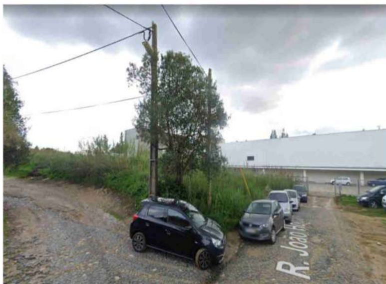
Apoios e cabos da rede aérea de telecomunicações e energia
