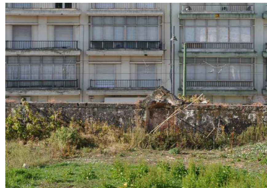
7.4/8.4 Vista do muro a partir do terraço da Escola da Voz do Operário - Pormenor
